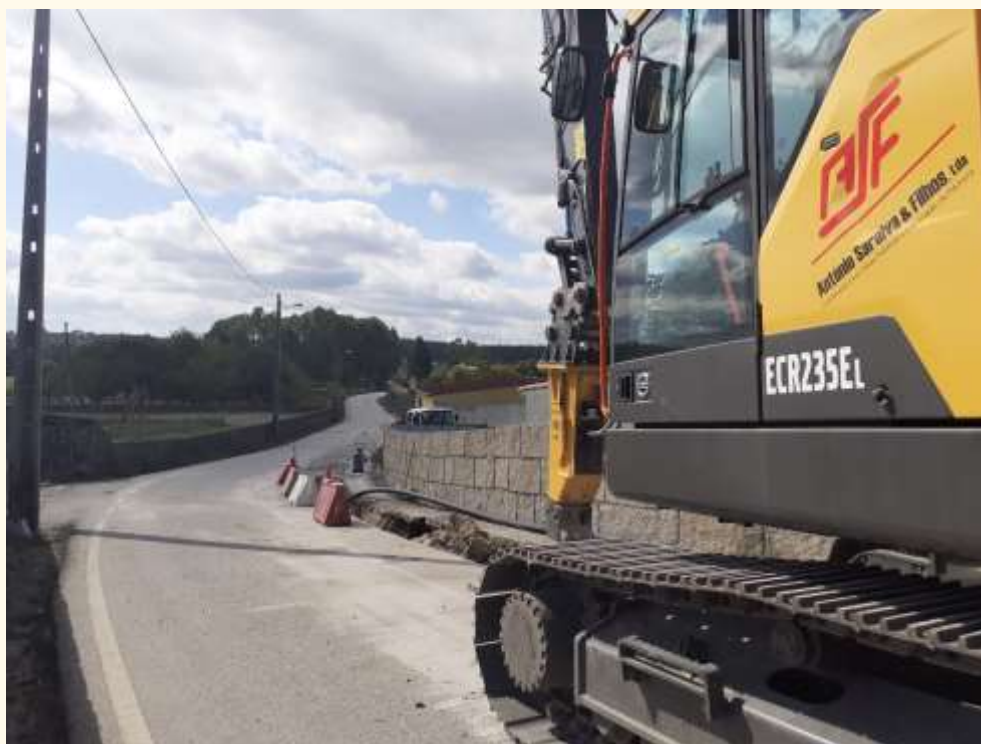
19255 – Sistema de saneamento de Aguiar da Beira – Subsistema do Eirado
